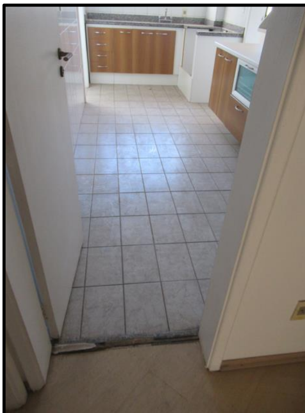
Foto 42: Piso deteriorado da entrada da cozinha
