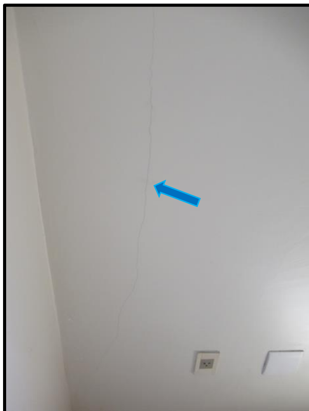
Foto 46: Detalhe da trinca na parede da janela
