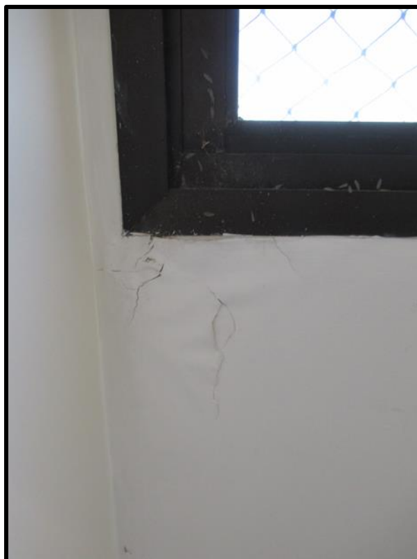
Foto 21: Janela com vestígio de infiltração de água
