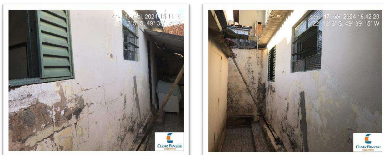
Figura 13 – Acesso a edícula - Fonte: Perícia.
