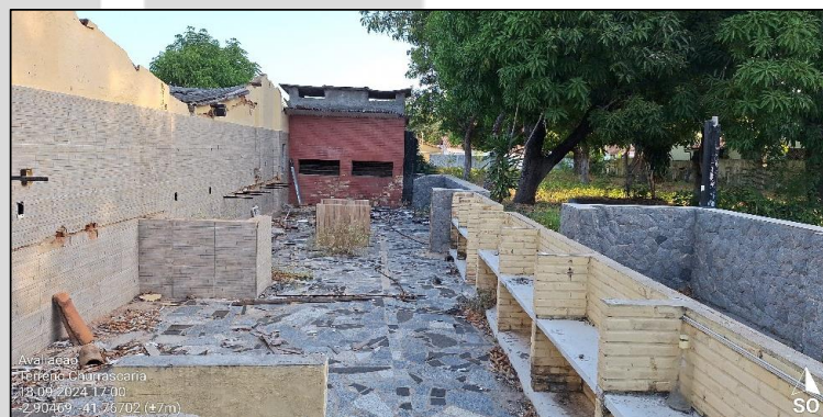
Imagem 6: Apresenta as ruínas da cozinha e ausência de cobertura.
