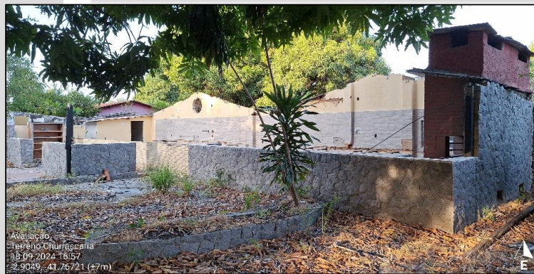
Imagem 5: Apresenta as ruínas da cozinha e ausência de cobertura.
