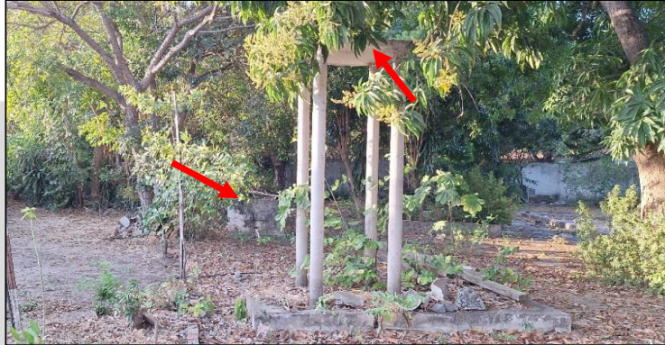
Imagem 10: Apresenta a base de caixa d'água e casa de bombas.
