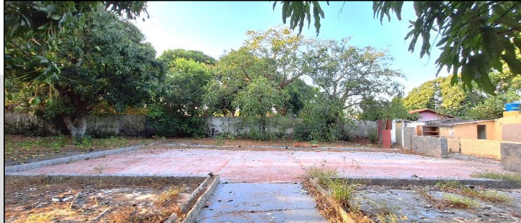
Imagem 4: Apresenta o salão principal com piso em cimento e ausência de cobertura.
