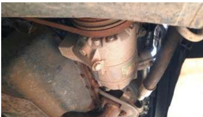
Foto Ar Condicionado
