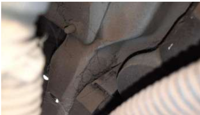
Foto Avaria Painel Dianteiro
