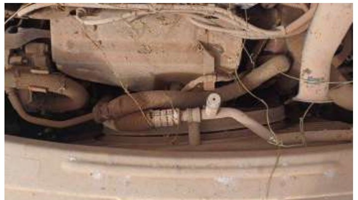
Foto Ar Condicionado
