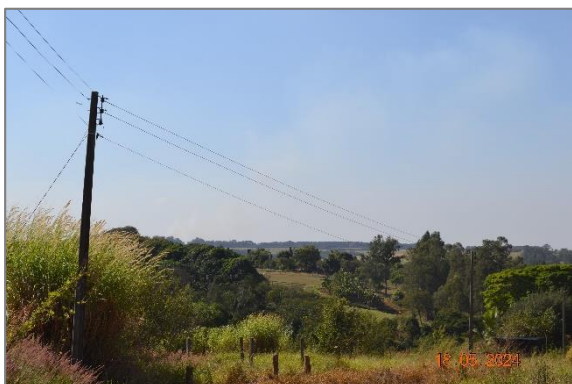
Foto 16 - Vista da Rede Elétrica na Área.
