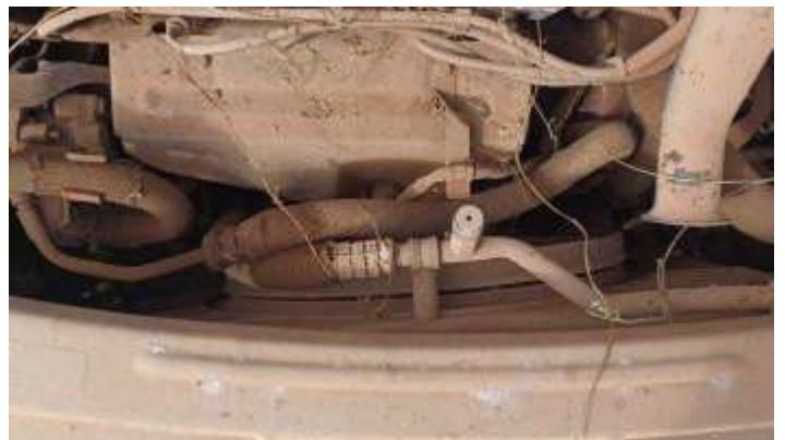
Foto Ar Condicionado
