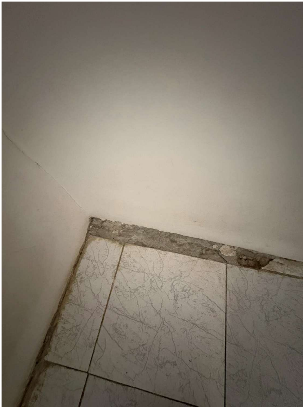
Figura 26: dormitório 03 – suíte – piso irregular
