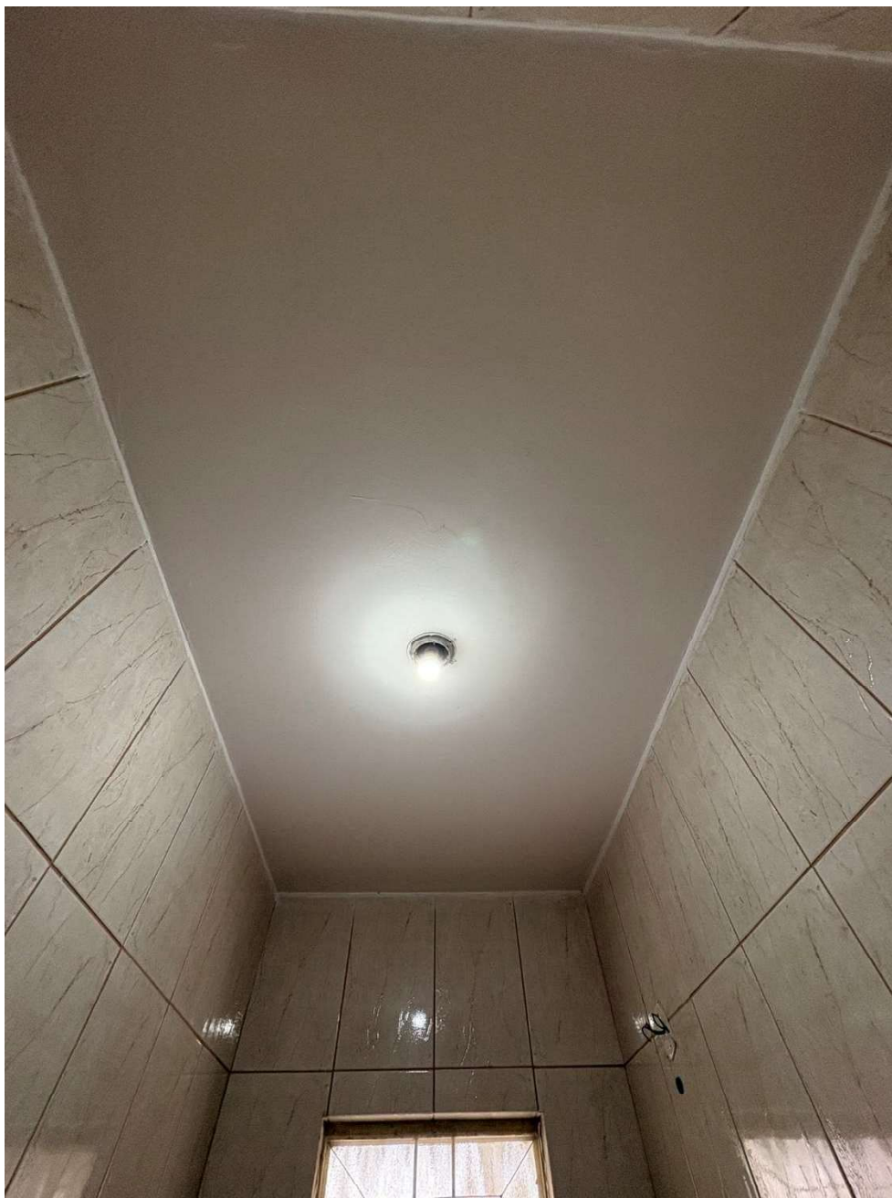
Figura 19: teto do banheiro
