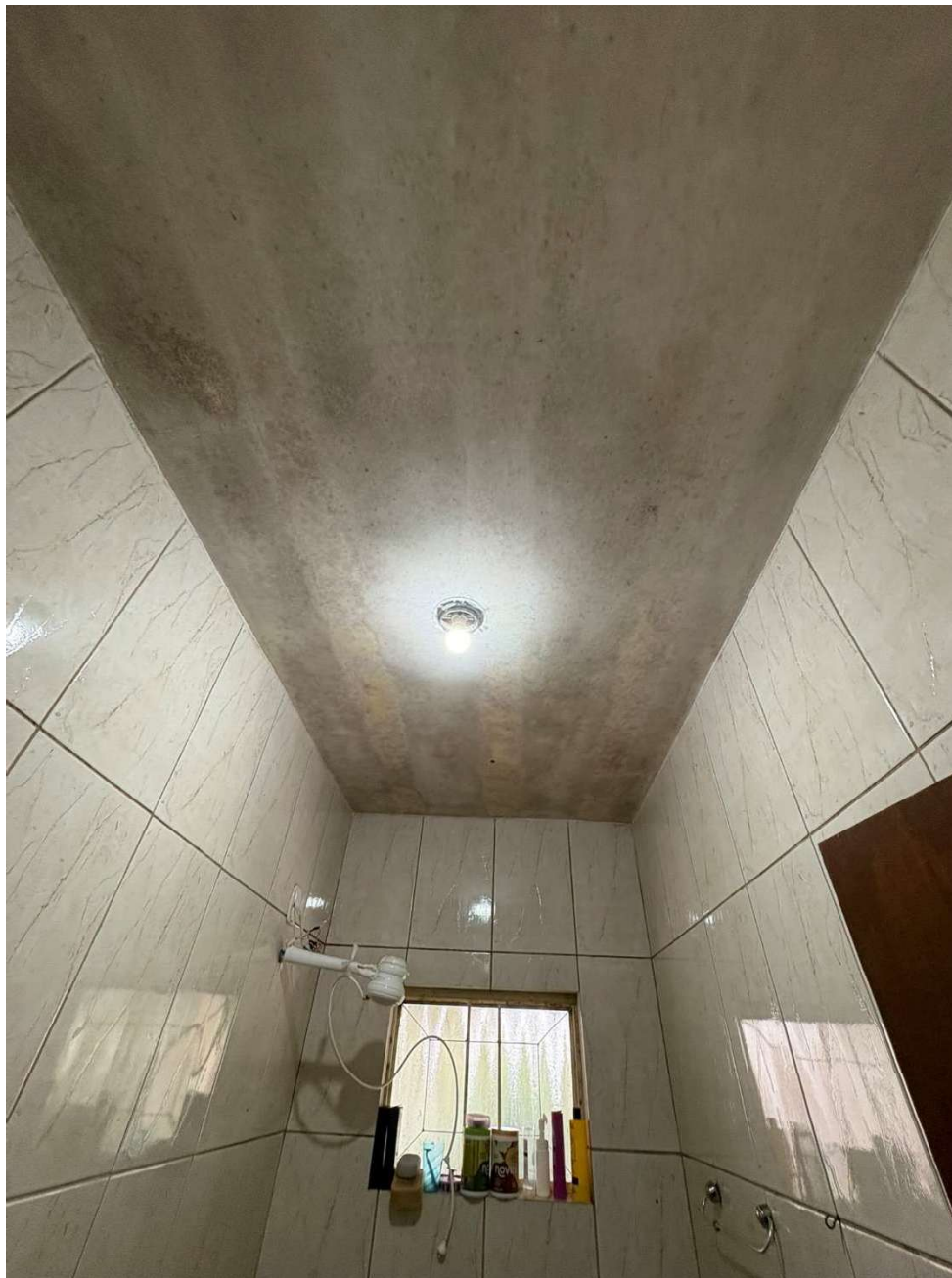
Figura 14: banheiro - teto com marca aparente de umidade
