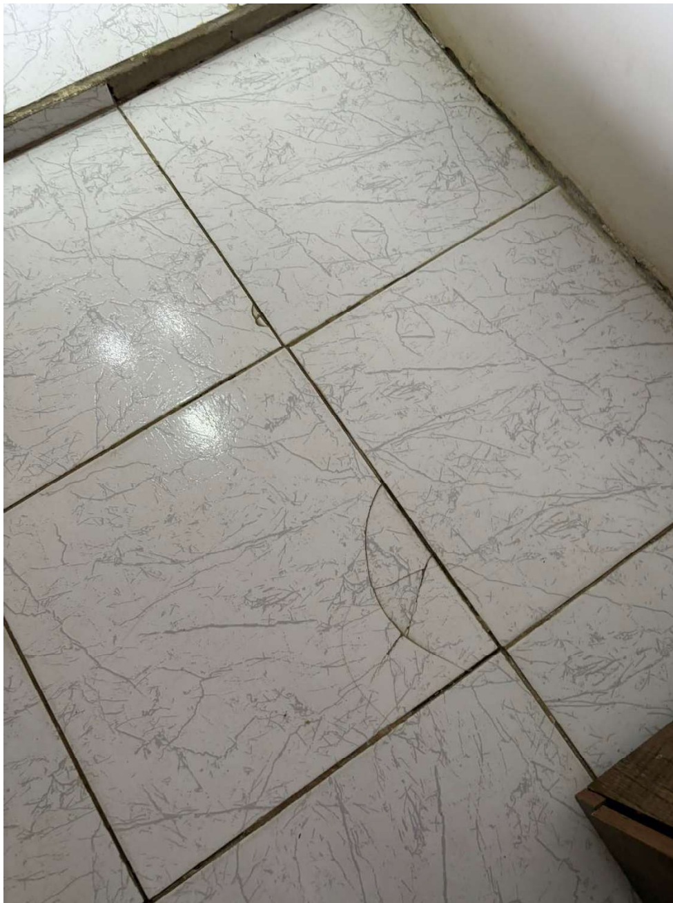
Figura 27: dormitório 03 – suíte - piso irregular
