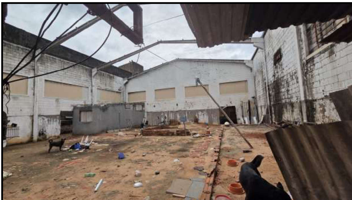
26. Parte dos fundos do galpão sem a cobertura e piso danificado.
