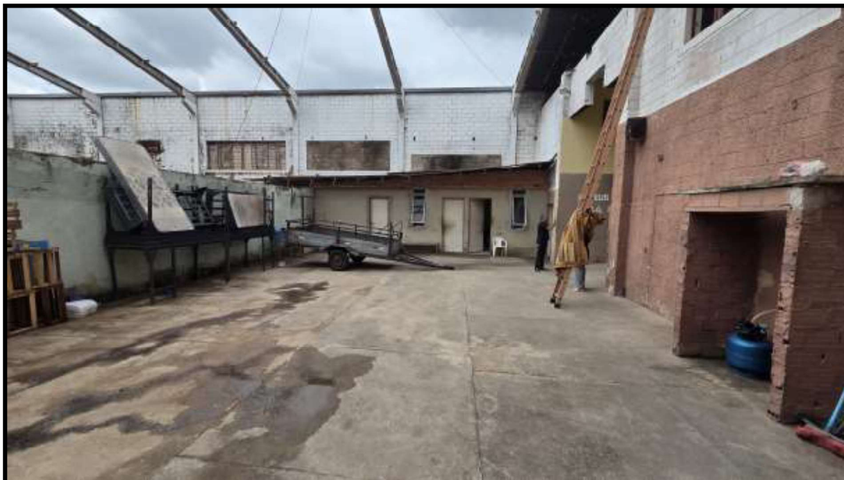
29. Parte da frente do galpão sem a cobertura e piso danificado. Vê-se parte do mezanino.
