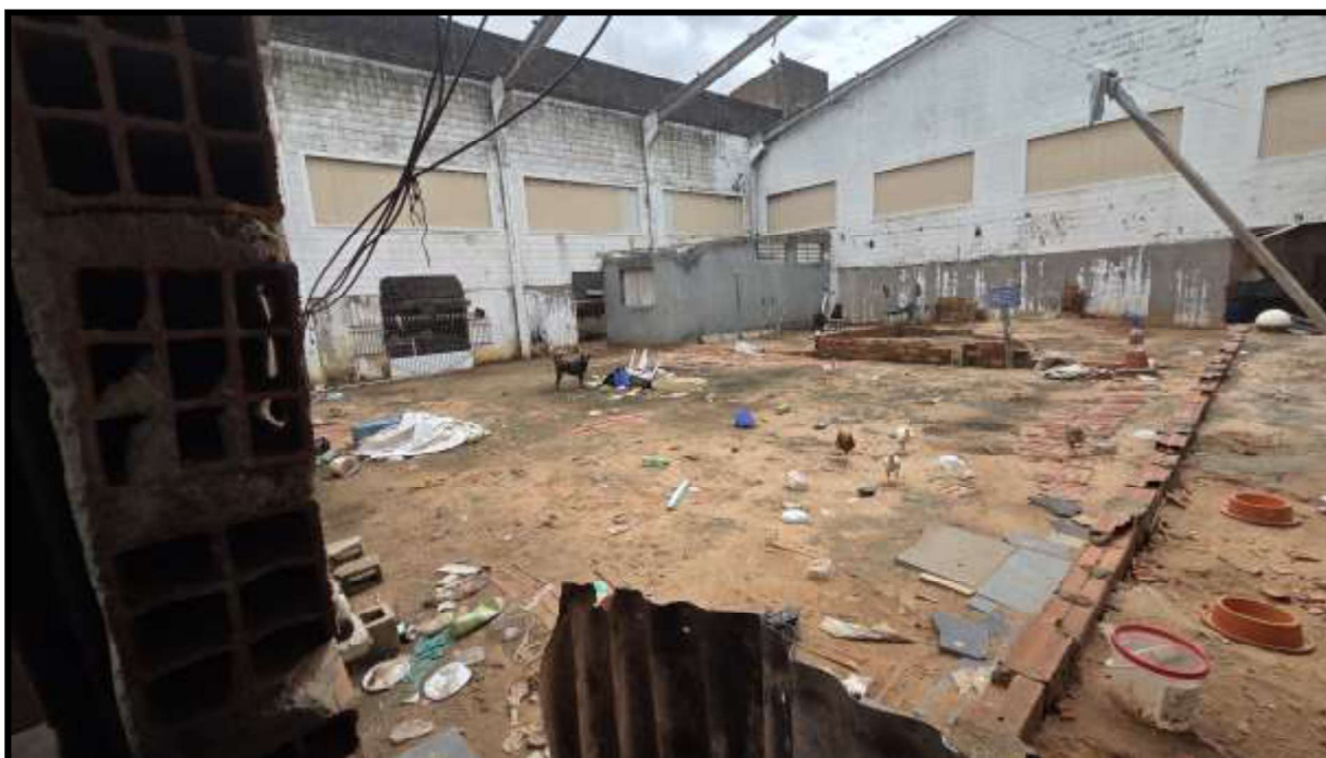
28. Parte dos fundos do galpão sem a cobertura e piso danificado.
