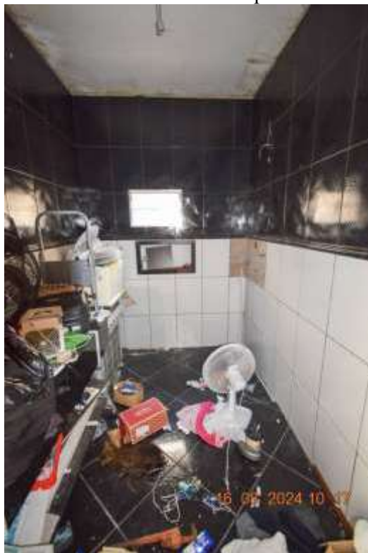
Banheiro social, desativado, sendo utilizado como espaço para despejo.
