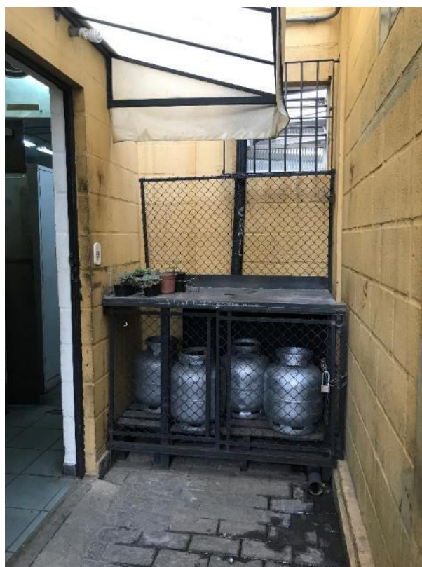
Foto 44: Abrigo de gás no pavimento térreo.
