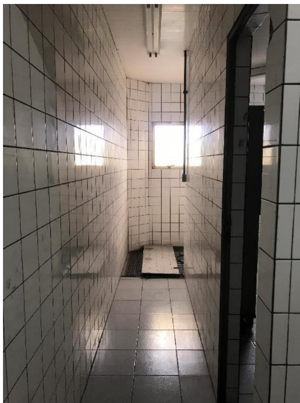
Foto 32: Vão próximo ao banheiro do primeiro pavimento.
