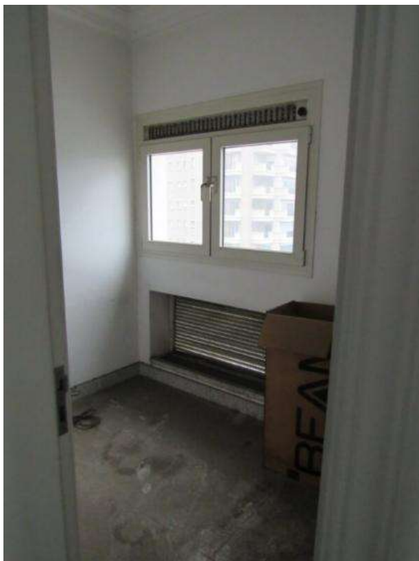
Foto 31 – Sala para ar-condicionado no pavimento inferior do apartamento
