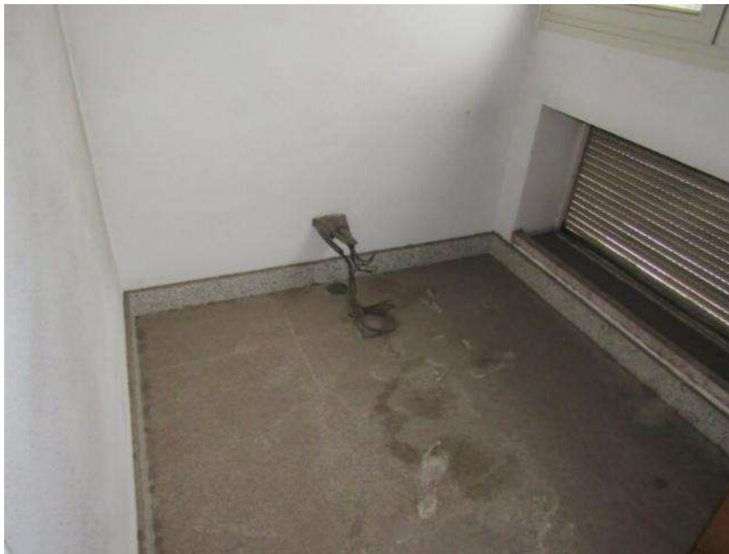
Foto 32 - Sala para ar-condicionado pavimento inferior do apartamento
