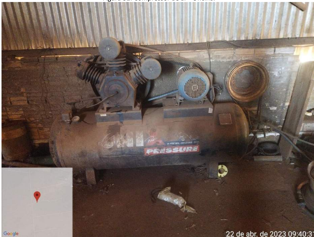
Figura 32: Compressor de ar - Oficina.
