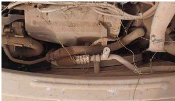
Foto Ar Condicionado
