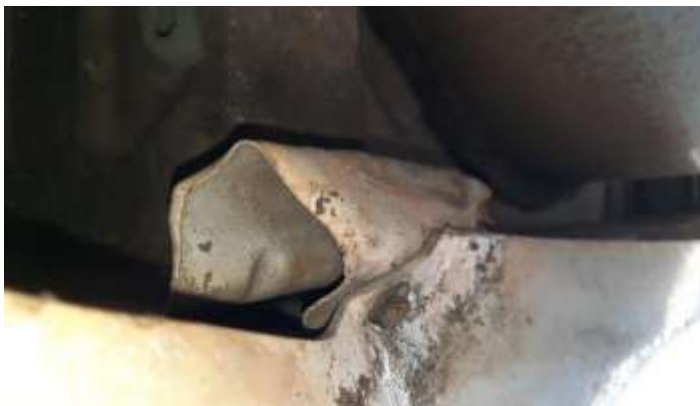
Foto Avaria Painel Traseiro
