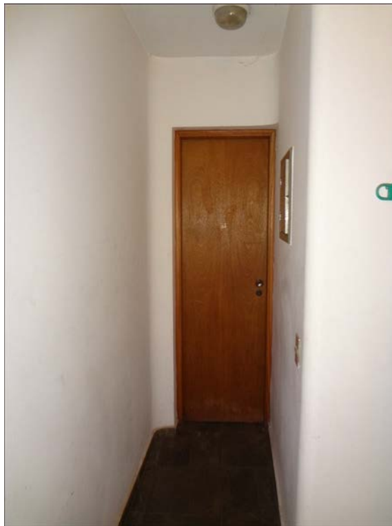
A foto ilustra a adega (subsolo) do imóvel objeto da lide pela Rua Irmão Gonçalo nº 31, no bairro Jardim das Bandeiras.
