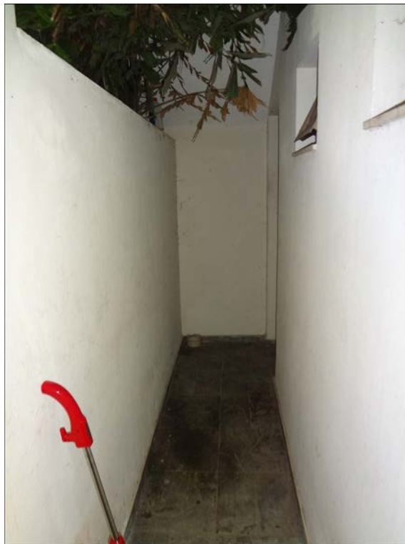
A foto ilustra a casa de máquinas da piscina (subsolo) do imóvel objeto da lide pela Rua Irmão Gonçalo nº 31, no bairro Jardim das Bandeiras.
