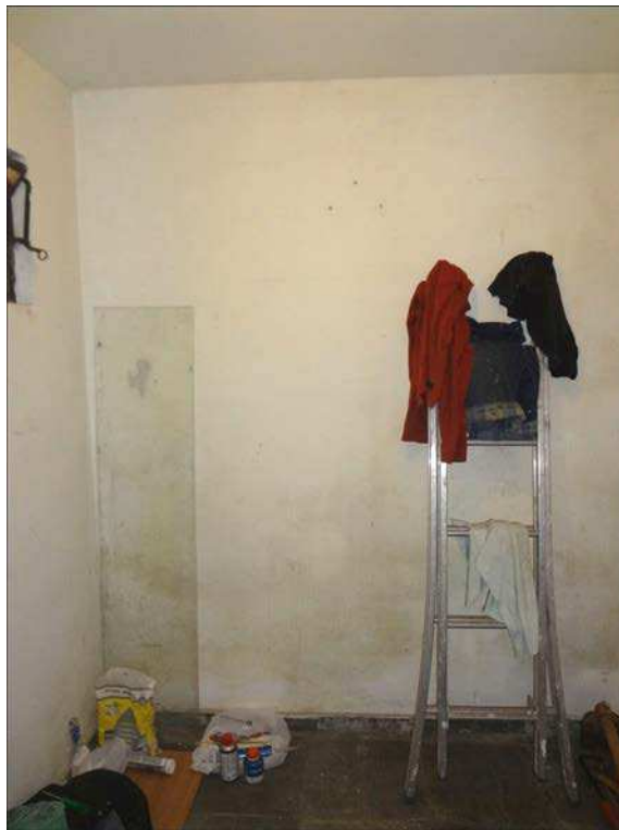
A foto ilustra o depósito (subsolo) do imóvel objeto da lide pela Rua Irmão Gonçalo nº 31, no bairro Jardim das Bandeiras.
