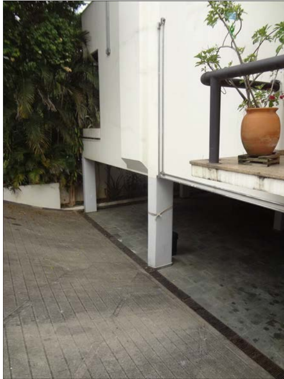
A foto ilustra parcialmente a fachada do imóvel objeto da lide situado na Rua Irmão Gonçalo nº 31, no bairro Jardim das Bandeiras.
