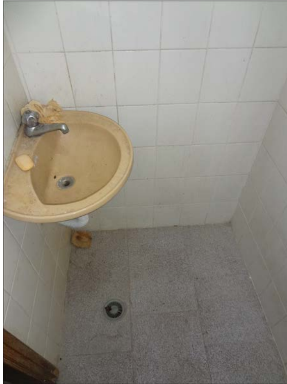
A foto ilustra o banheiro (subsolo) do imóvel objeto da lide pela Rua Irmão Gonçalo nº 31, no bairro Jardim das Bandeiras.
