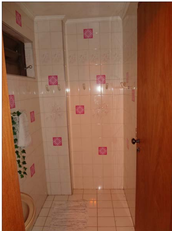
A foto ilustra o banheiro da sauna 2 (subsolo) do imóvel objeto da lide pela Rua Irmão Gonçalo nº 31, no bairro Jardim das Bandeiras.
