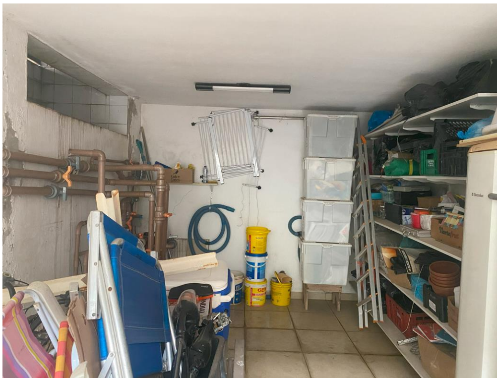
VISTA DA CASA DAS MÁQUINAS (SUBSOLO).
