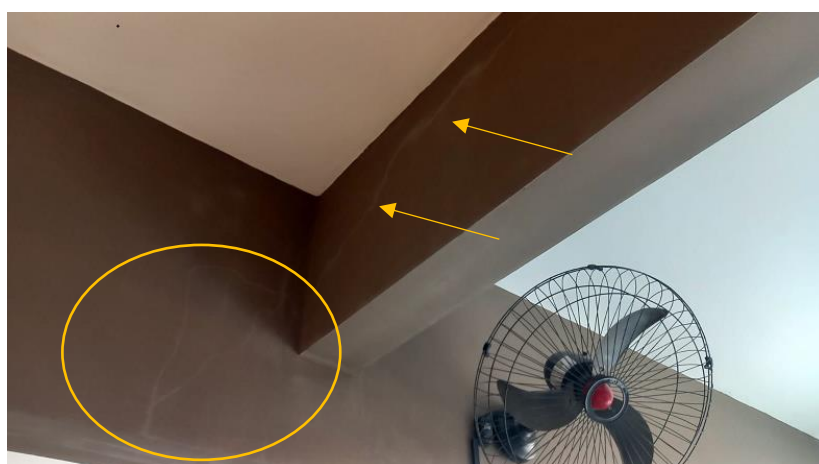
Foto 12: Vista das patologias do imóvel
