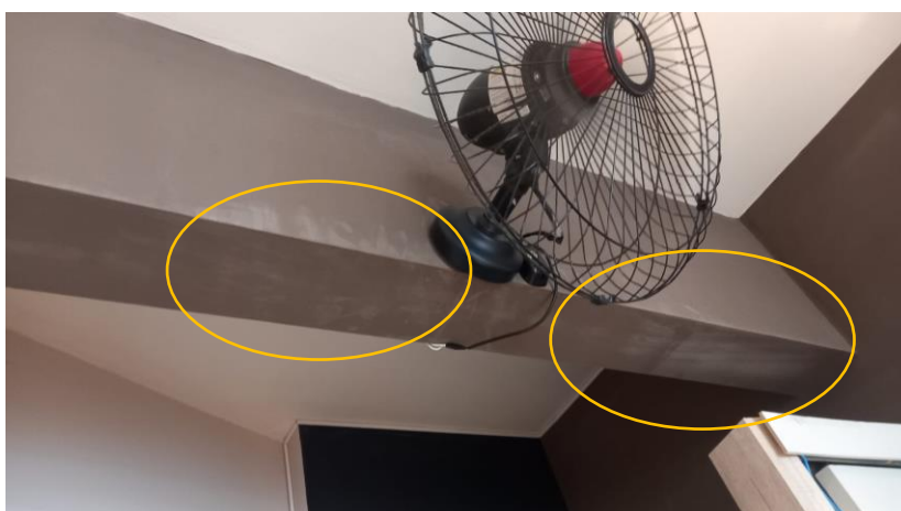
Foto 11: Vista das patologias do imóvel
