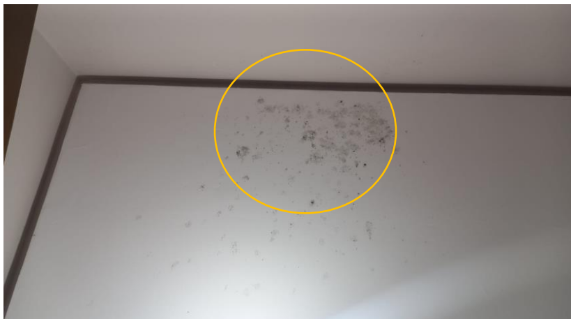
Foto 10: Vista das patologias do imóvel
