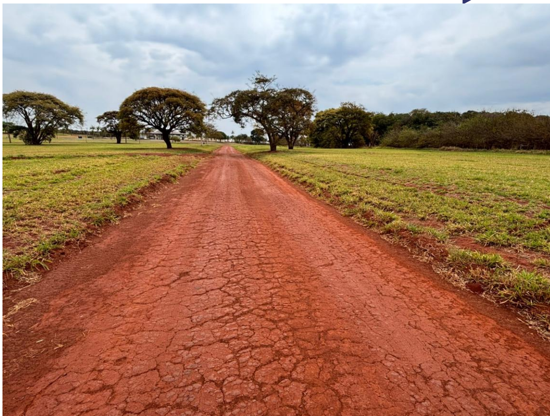
Imagem 9 – Via sem Pavimentação
