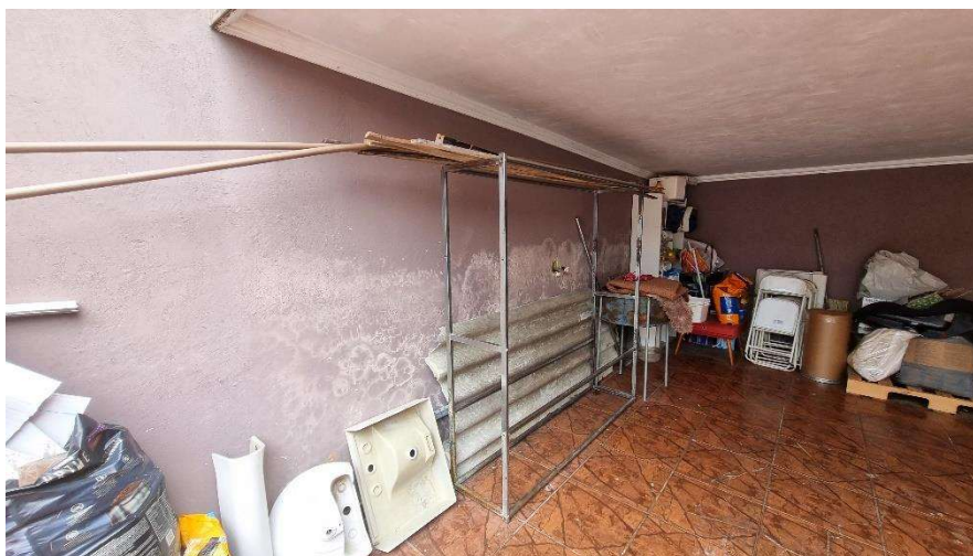
Detalhe da infiltração - garagem
