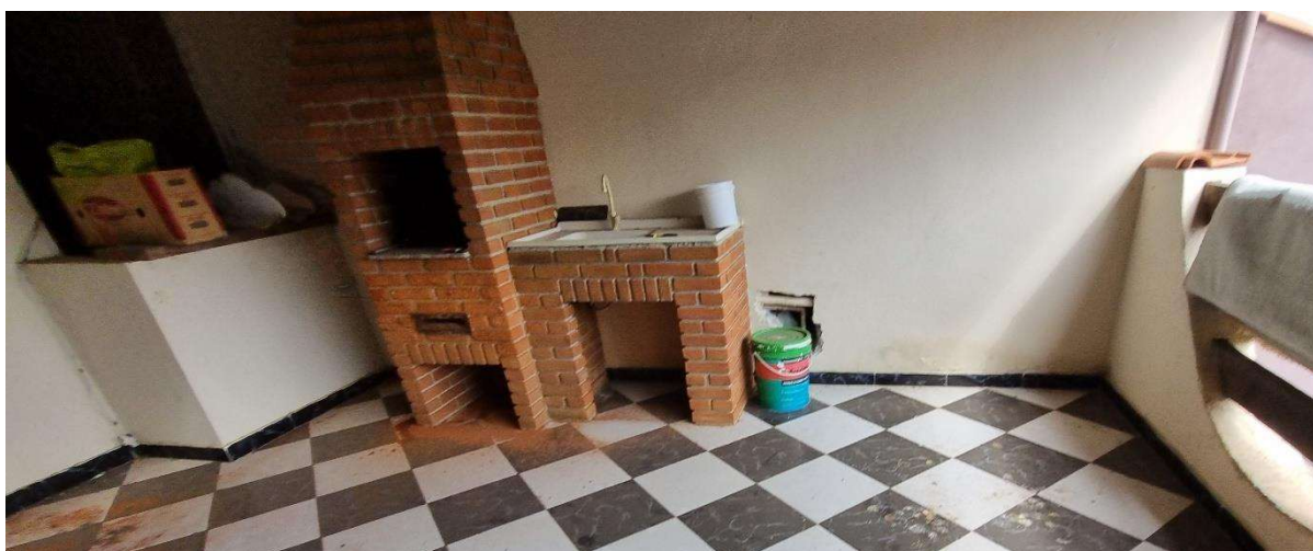
Detalhe da infiltração e umidades – churrasqueira e alvenaria
