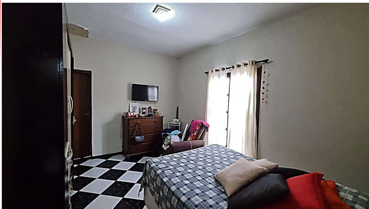
Vista dormitório (suíte) – observando umidade.
