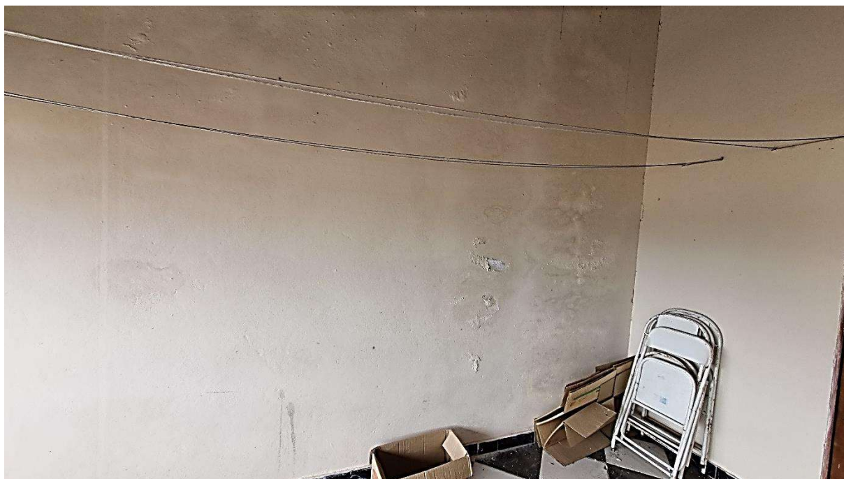
Detalhe das infiltrações
