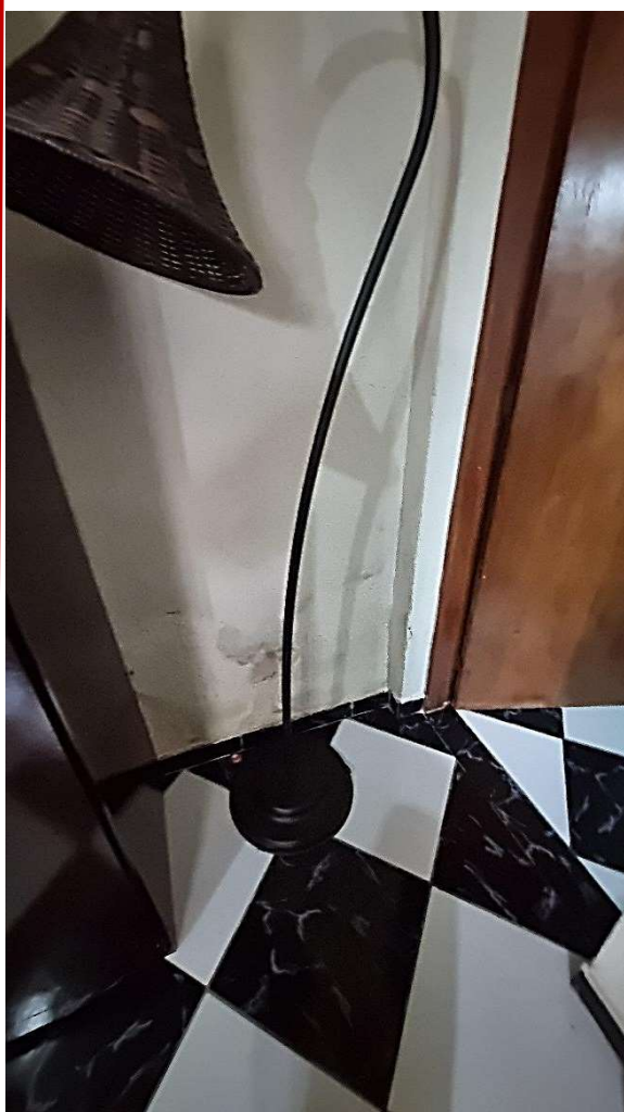
Detalhe umidade próximo acesso ao BWC.
