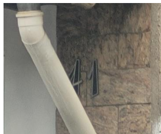
Fonte: registro fotográfico do dia da vistoria.
