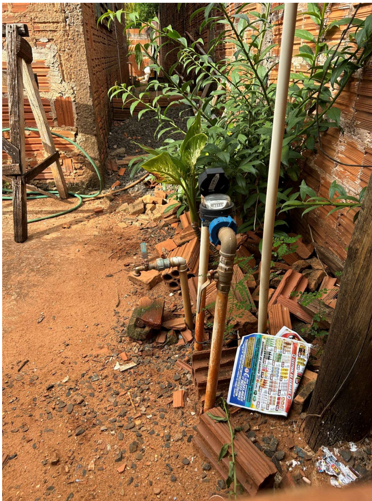
VISTA DO HIDRÔMETRO.
