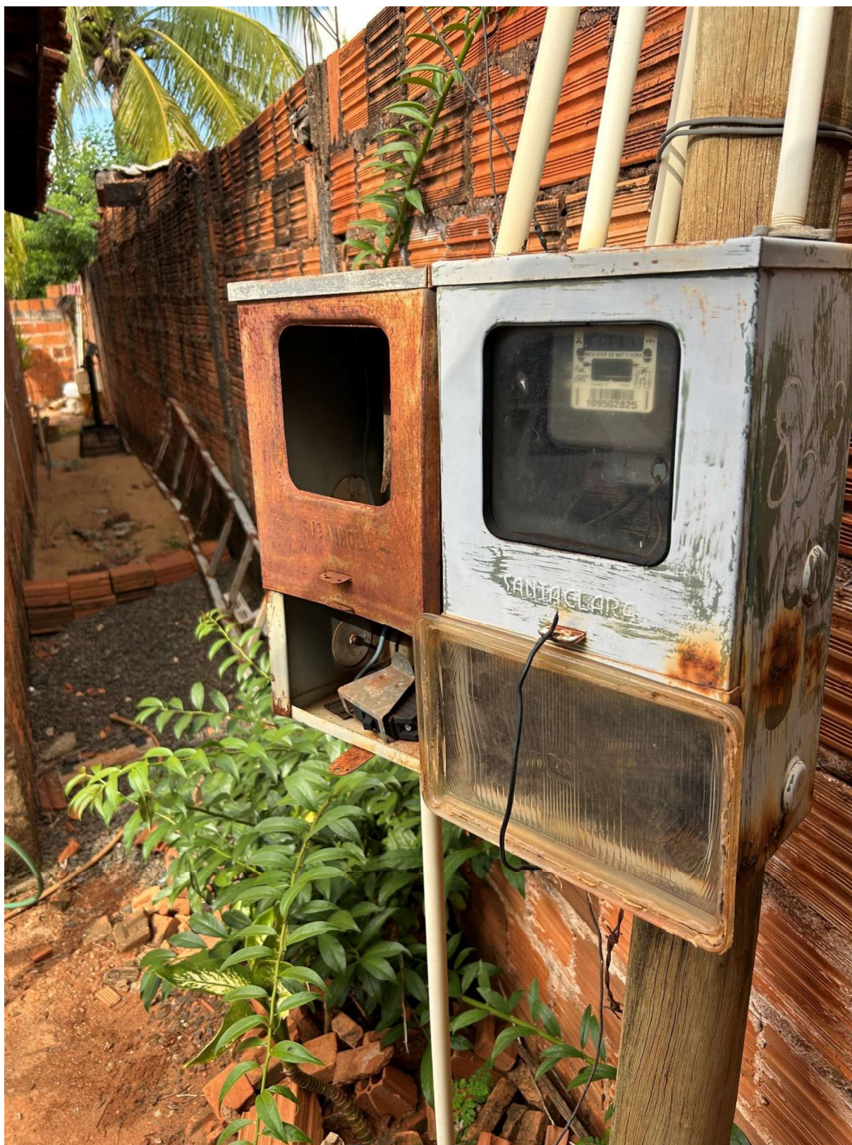
VISTA DO RELÓGIO MEDIDOR DE ENERGIA DO IMÓVEL.
