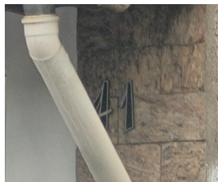
Fonte: registro fotográfico do dia da vistoria.
