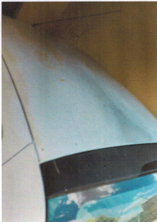
Teto com pintura danificada
