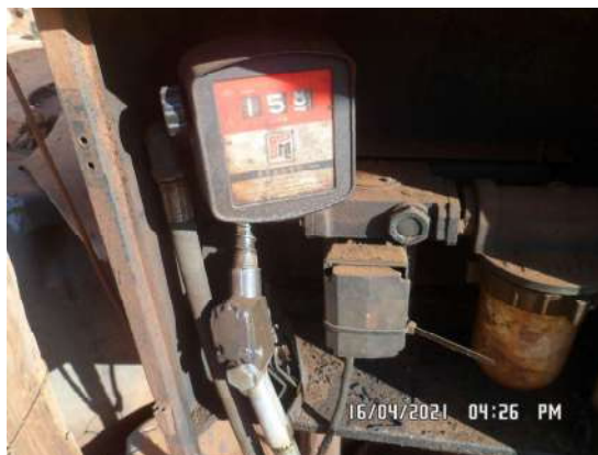
Foto 32: Equipamentos do tanque de óleo diesel (Estado de conservação: REGULAR).
