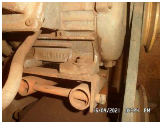
Foto 29: Bomba de lavagem, número de série 600184562 (Estado de conservação: REGULAR).
