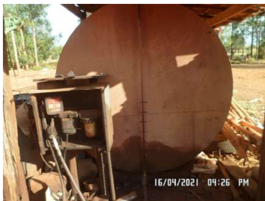
Foto 31: Tanque de óleo diesel, diâmetro 1,90m, comprimento 2,40m, capacidade aproximada = 7.000 litros (estado de conservação: REGULAR).
