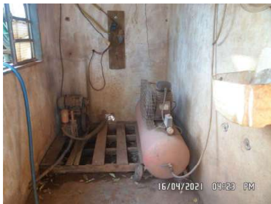
Foto 27: Compressor de ar, marca MAC, número de série 061796 (Estado de conservação: REGULAR).
