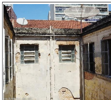
DET. FACHADA DETERIORADA
