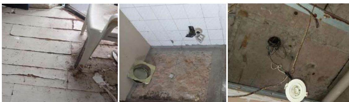
Fotos 44 a 46: Vistas das patologias do imóvel
