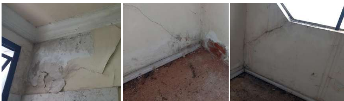
Fotos 47 a 49: Vistas das patologias do imóvel
