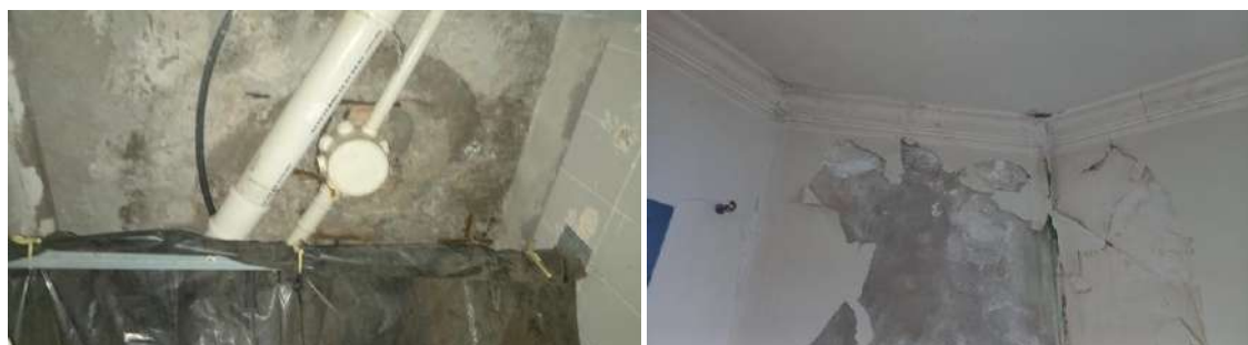
Fotos 50 e 51: Vistas das patologias do imóvel
