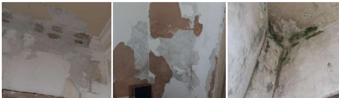
Fotos 41 a 43: Vistas das patologias do imóvel
