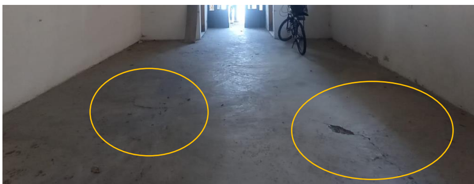
Foto 22: Vistas das patologias do imóvel.
