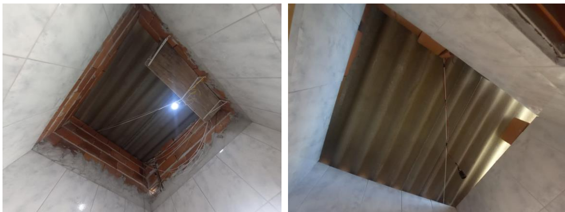
Fotos 19 e 20: Vistas das patologias do imóvel.
