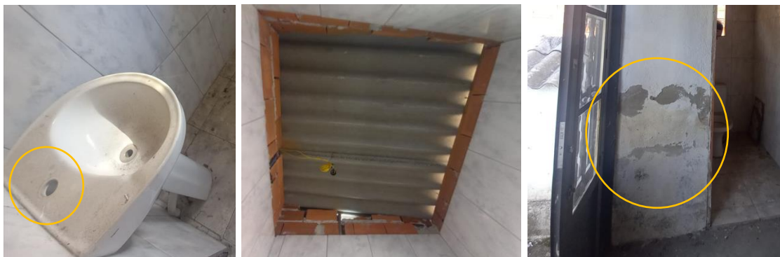
Fotos 16, 17 e 18: Vistas das patologias do imóvel.
