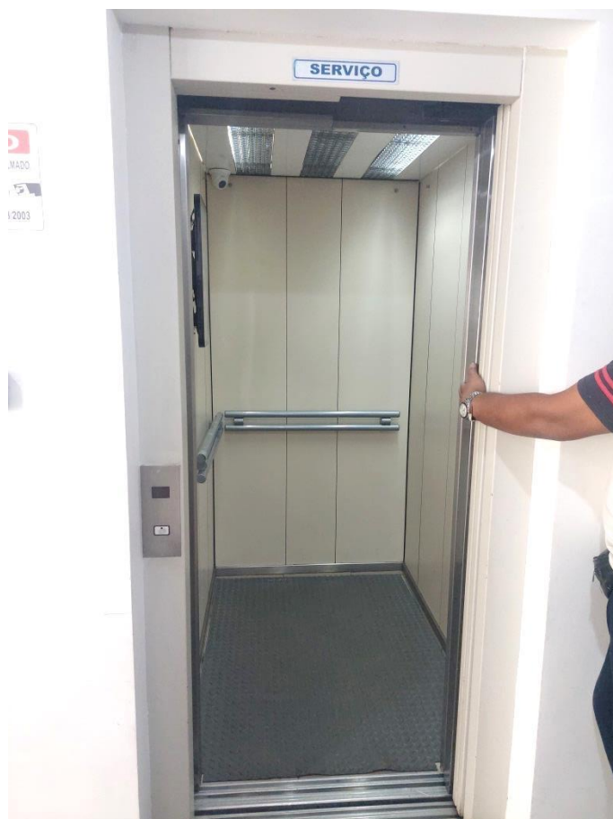
31- Elevador de Serviço;
