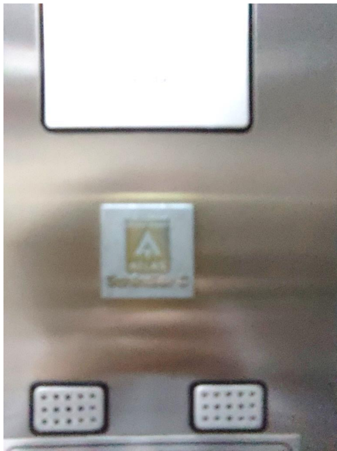
31- Detalhe do Elevador;
