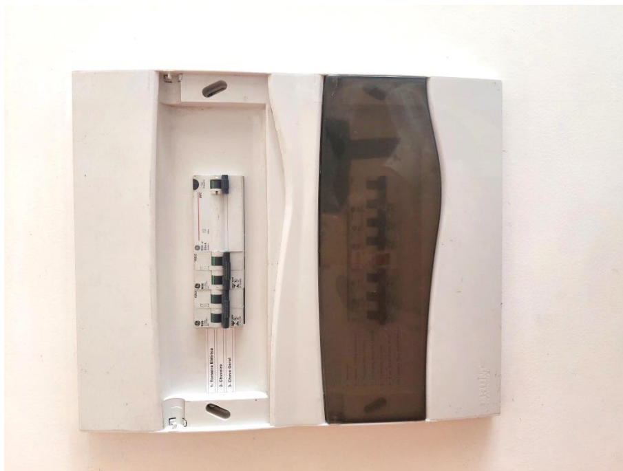
16 – Quadro de disjuntores da unidade;
