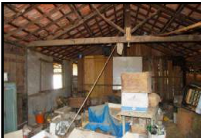
Foto 10 – Estado de conservação precário vista interna.
