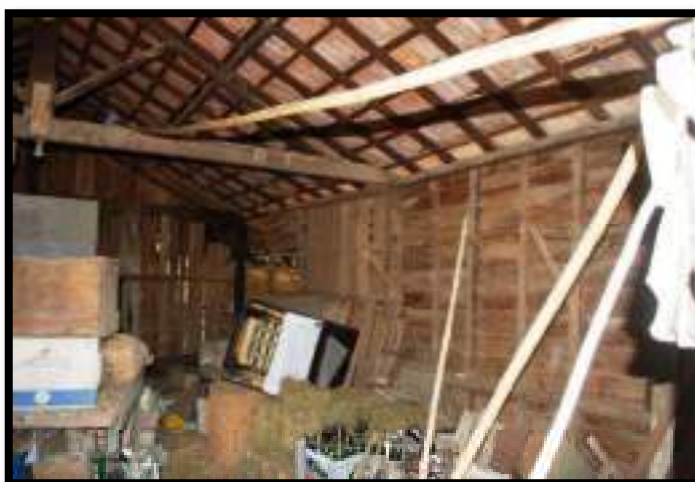
Foto 11 – Estado de conservação precário vista interna 2
