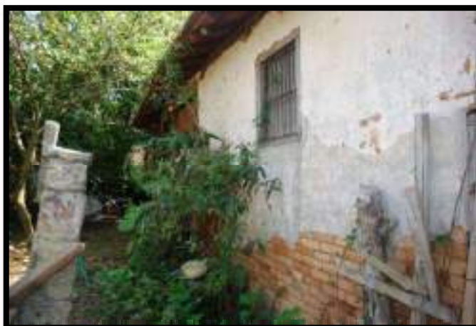
Foto 5 e 6 – Estado de conservação precário
