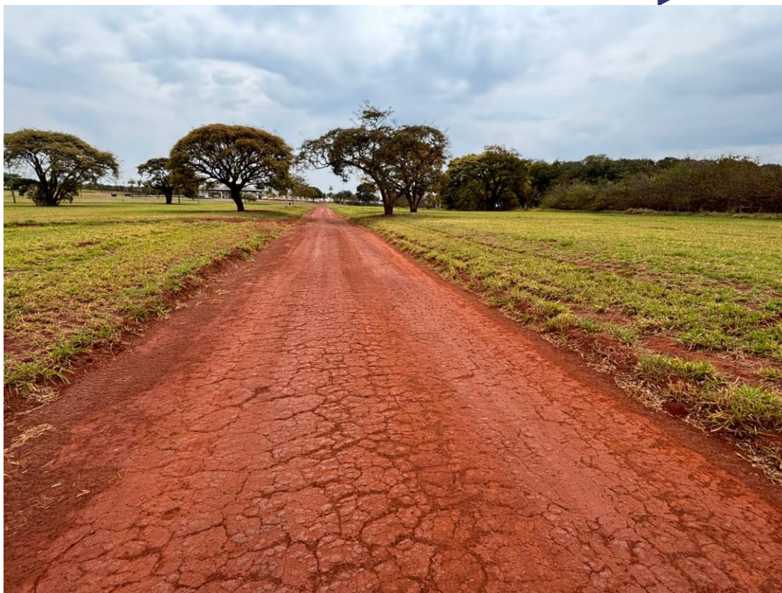
Imagem 9 – Via sem Pavimentação
