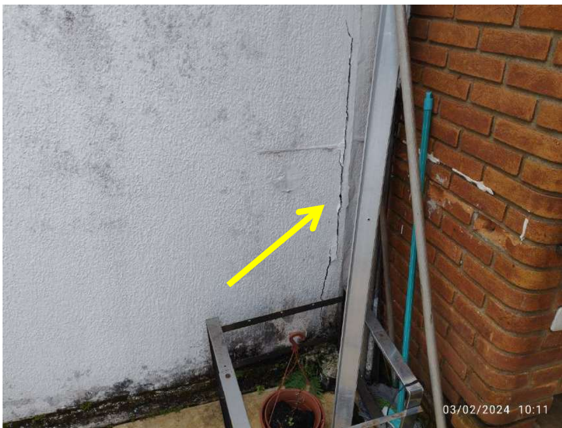
Figura 19 - Manifestação patológica: Fissuras no muro de divisa do Quintal
