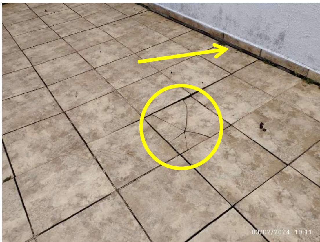
Figura 15 – Manifestação patológica: Afundamento do piso do Quintal
