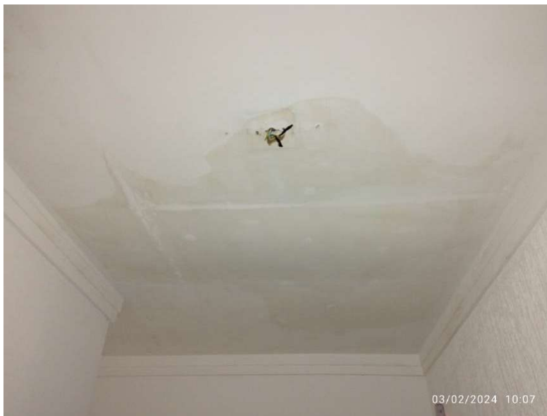
Figura 28 – Manifestação patológica: Infiltração no Hall dos dormitórios
