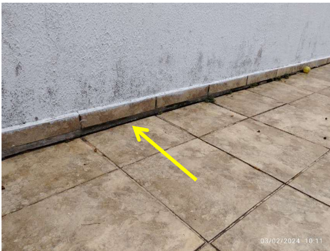
Figura 16 - Manifestação patológica: Afundamento do piso do Quintal
