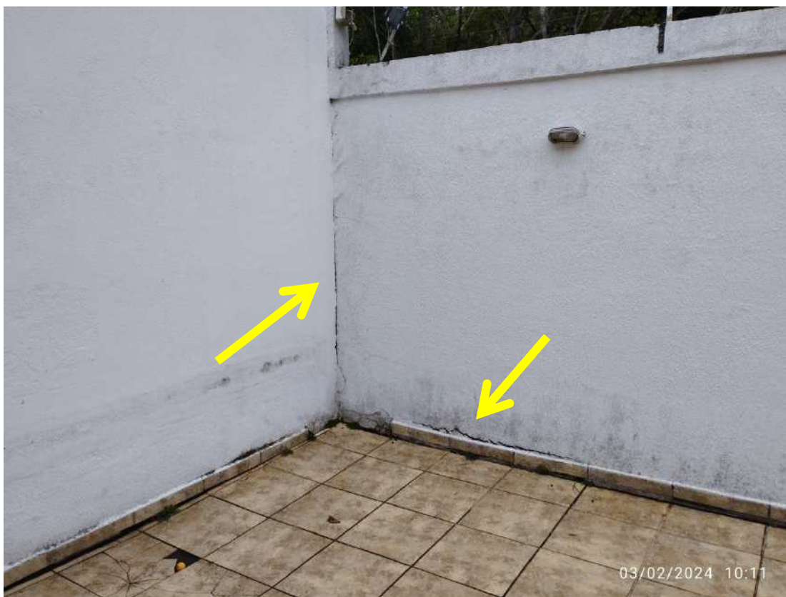
Figura 20 - Manifestação patológica: Fissuras no muro de divisa do Quintal
