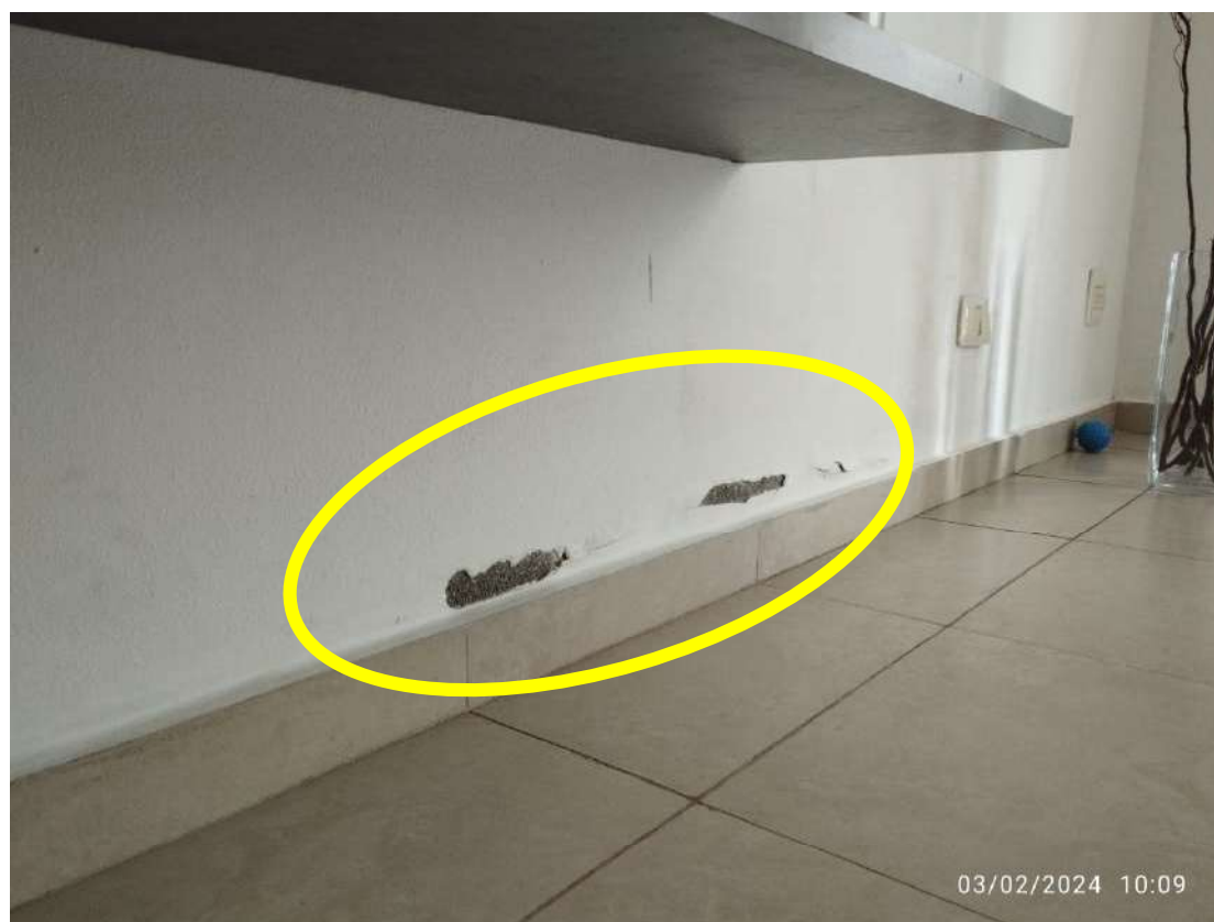
Figura 11 – Manifestação patológica: Umidade no rodapé da Sala de TV
