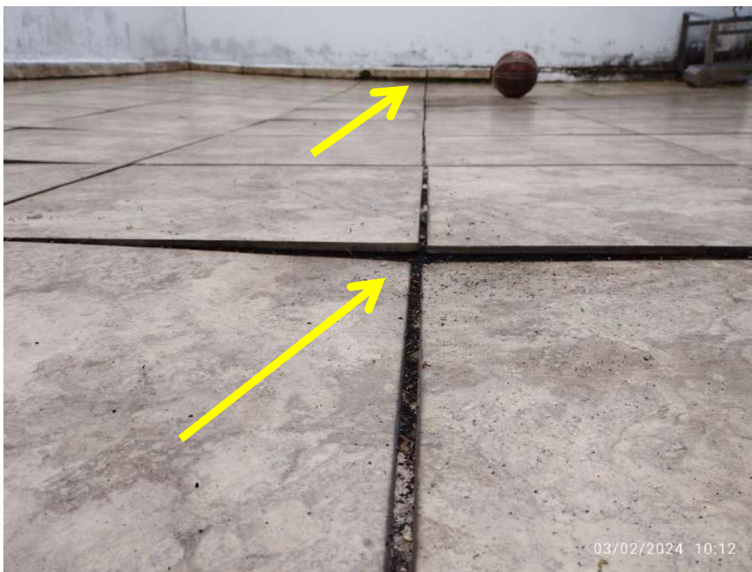
Figura 17 - Manifestação patológica: Afundamento do piso do Quintal
