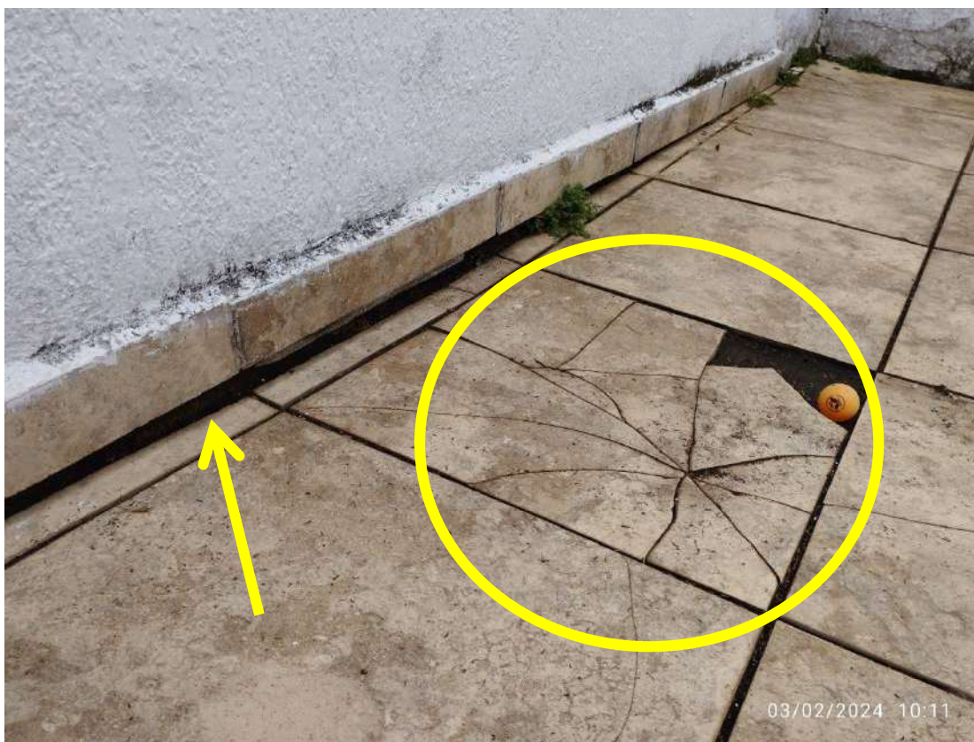
Figura 18 - Manifestação patológica: Afundamento do piso do Quintal
