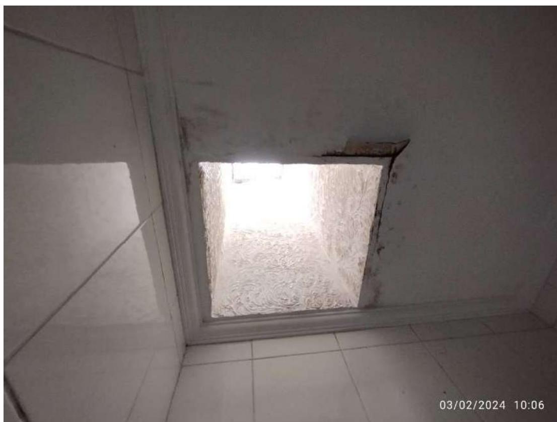
Figura 37 – Manifestação patológica: Infiltração no Banheiro do Suíte 3
