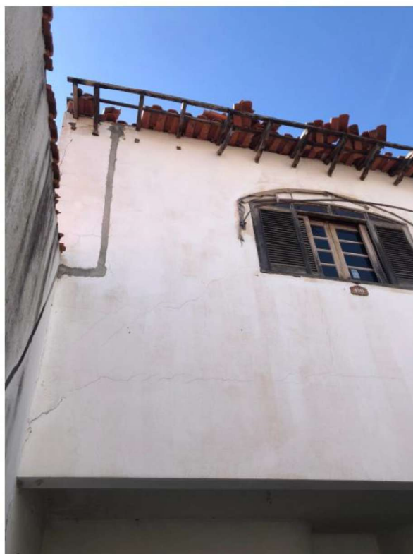
FACHADA. DESTAQUE PARA SITUAÇÃO DO TELHADO
