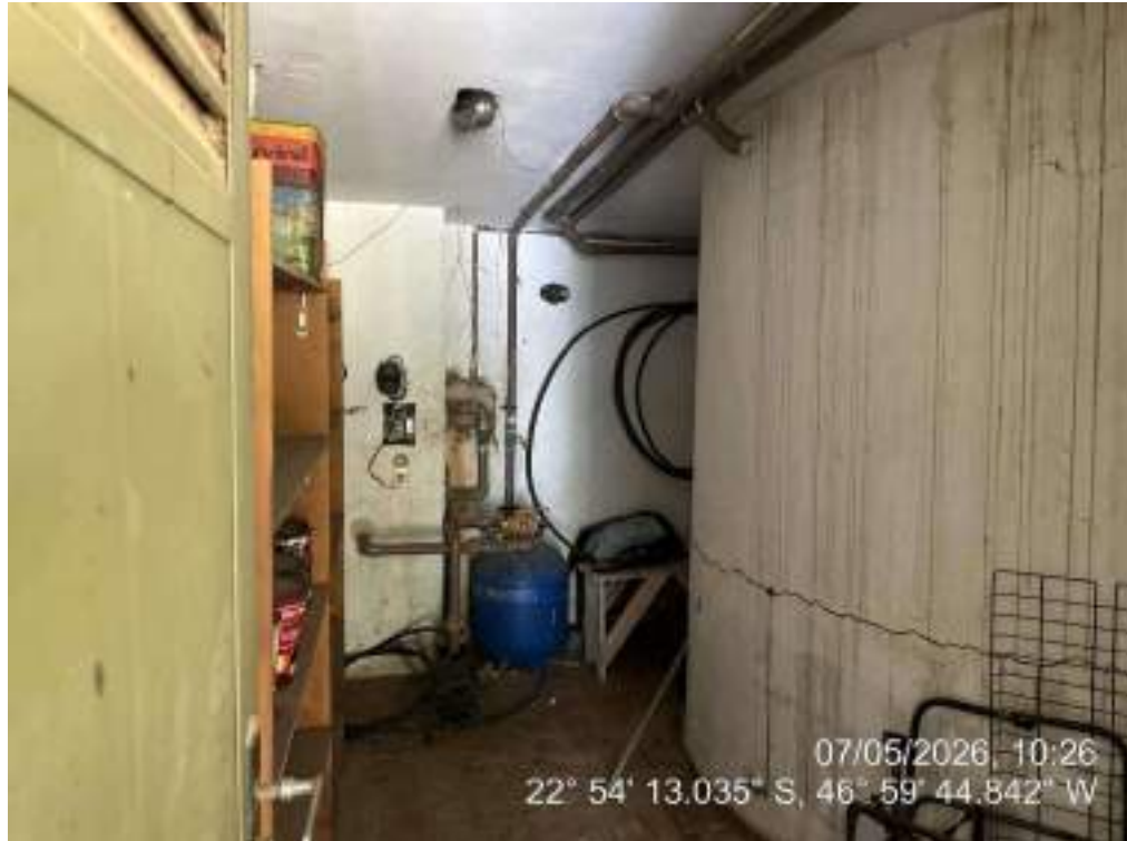
FOTO 13 – CASA DE MÁQUINAS
